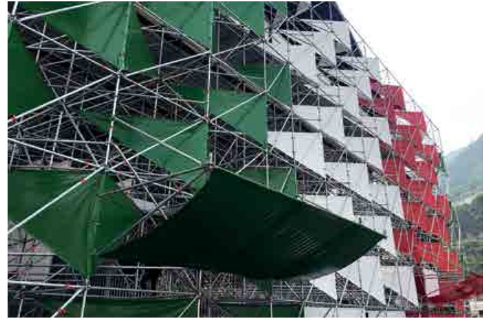
Il palco allestito in cantiere per la cerimonia del varo Sergio de Luyk
